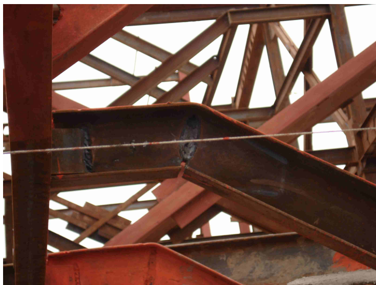
شکل شماره ۱۷- باز هم اجرای نامناسب قسمت اتصال شمشیری به تیرآهن پاگرد پله (دقت کنید علاوه بر بکار نبردن پلیت اتصال جان فاصله درز چقدر زیاد است یعنی آماده سازی اتصال قبل از جوشکاری بسیار بد بوده و چقدر هم نامناسب سعی شده تا این درز با جوش پر شود)
