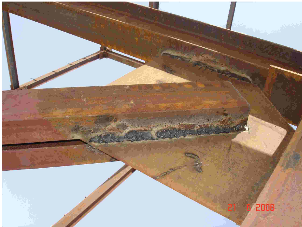
شکل شماره ۲۵- نظارت این محل یعنی محل اتصال بادبند به پلیت اتصال فوقانی بسیار مهم است چون معمولاً جوش سقفی این ناحیه بسیار بد اجرا میشود - نگاه کنید که این جوش چقدر غیر
