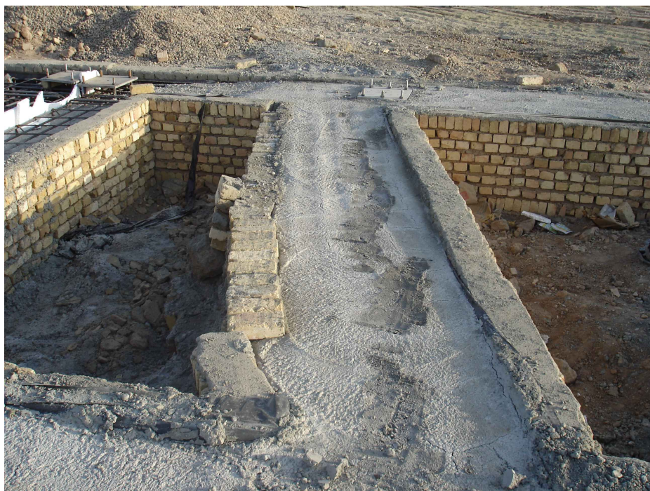
شکل ۲- خالی بودن پشت دیواره قالب موقع بتن ریزی و حرکت دیواره قالب و در نتیجه آسیب به هندسه فونداسیون بتنی
