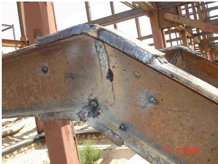
شکل شماره ۱۶- عدم اجرای پلیت اتصال در قسمت جان محل اتصال شمشیری به تیرآهن پاگرد http://omidi2010.blogsky.com (وبلاگ مهندس امیدی)
