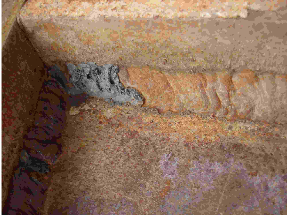
شکل شماره ۲۴- دقت کنید در انتهای این خط جوش سوختگی کاملاً قابل رویت است (معمولاً بالا بودن آمپر و در نتیجه حرارت زیاد موجب چنین اشکالاتی میشود)
