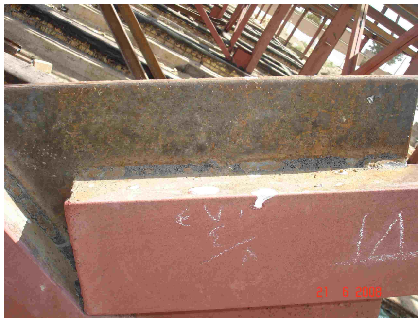
شکل شماره ۳۱- یک جوش با تخلخل زیاد اگر دقت کنید حفره های بسیار ریز را روی سطح جوش مشاهده میکنید این اشکال در اثر وجود رطوبت (در الکتروود یا سطح فلز) یا وجود چربی و روغن و کلا تمییز نبودن سطح کار بوجود می آید
