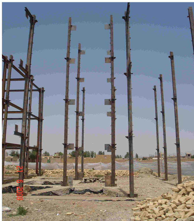
شکل شماره ۱۰- اسقرار ستونها و رها کردن آنها بدون مهار جانبی که بسیار خطرناک است چون در این حالت امکان سقوط ستون در اثر وزش باد وجود دارد باید ستونها را توسط اجرای مهاربندی ضربدري موقت با ميلگرد و جوش در مقابل نيروی جانبي باد ايمن کرد
