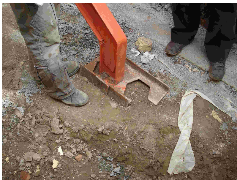
شکل شماره ۱۵- اجرای عجیب و غریب در تعبیه فونداسیون در قسمت انتهایی شمشیری پله
