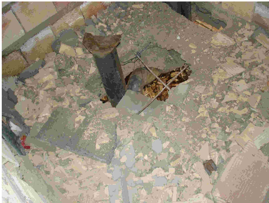
شکل شماره ۳۰- کف سرویس- در اثر عدم هماهنگی و دقت در نقشه های تاسیسات و سازه ای مجبور به تخریب سقف بتنی با پتک و قلم برای عبور لوله فاضلاب شده اند http://omidi2010.blogspot.com (وبلاگ مهندس امیدی)
