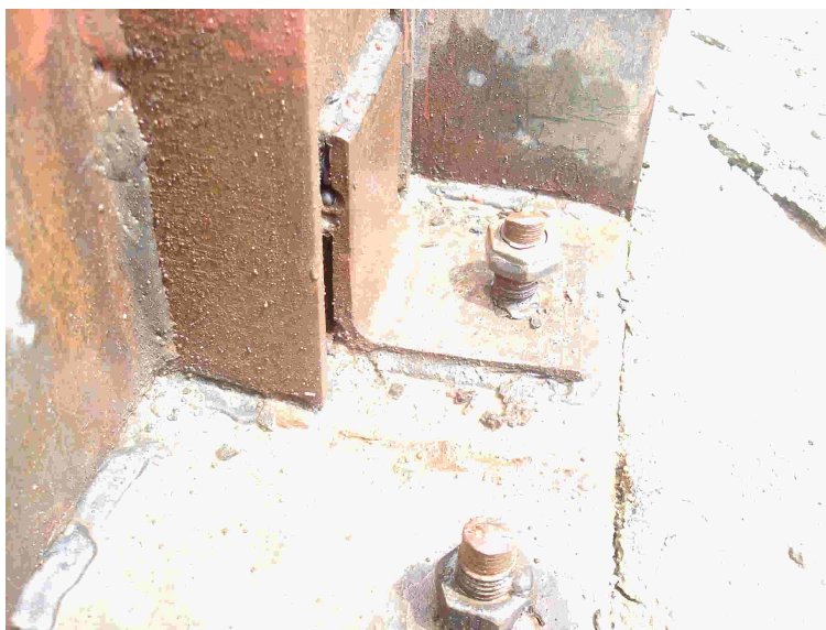
شکل شماره ۸- عدم بستن و محکم کردن مهره های بولت و زدن خال جوش روی مهره (اجرای خال جوش روی بولتها ممنوع است چون بولتها از فولاد ترد(AIII) هستند)
