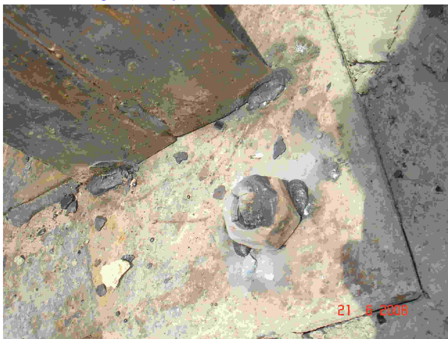
شکل شماره ۹- استفاده از مهره بزرگتر از رزوه بولت و جوش کاری کردن مهره و بولت که کاریست متداول و غلط
