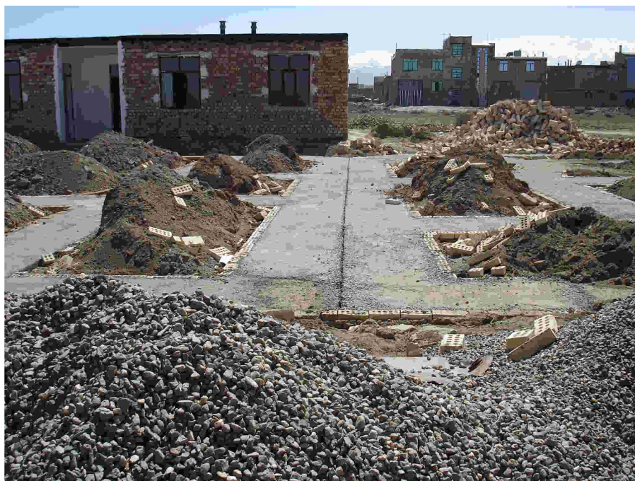
شکل ۳- ریختن خاک و نخاله ساختمانی در قسمتهای خارجی قالبهای فونداسیون و عدم اجرای بلوکاژ
