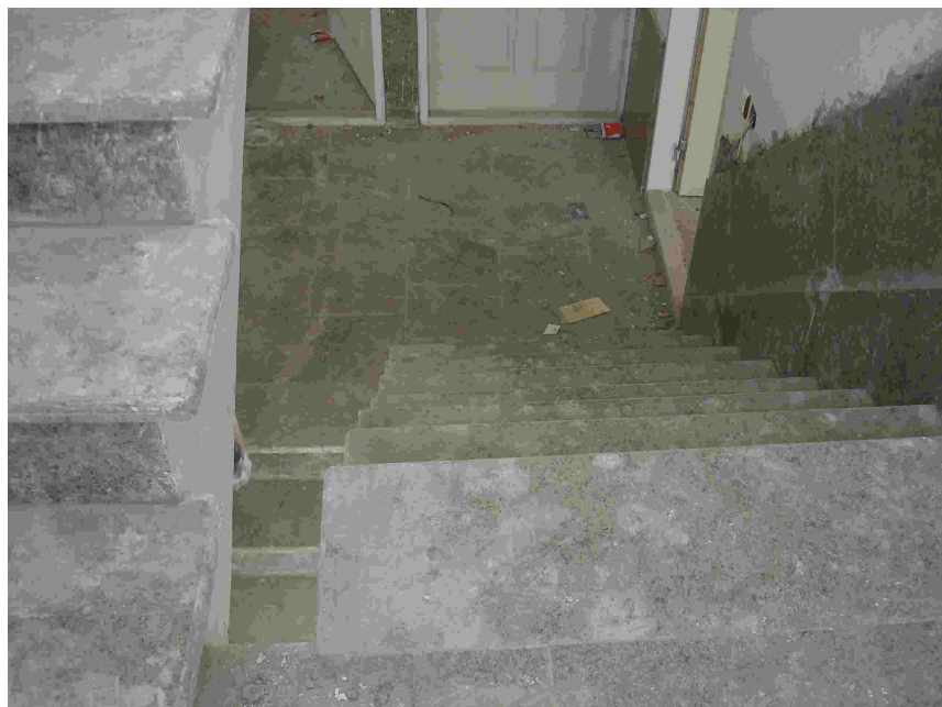
شکل شماره ۳۳- سنگهای کف پله در یک راستا اجرا نشده اند و اندازه چشم پله یک مقدار ثابت ندارد احتمالاً سنگهای کف با دیوار کناری که کاملاً شاقولی نبوده تراز شده اند
